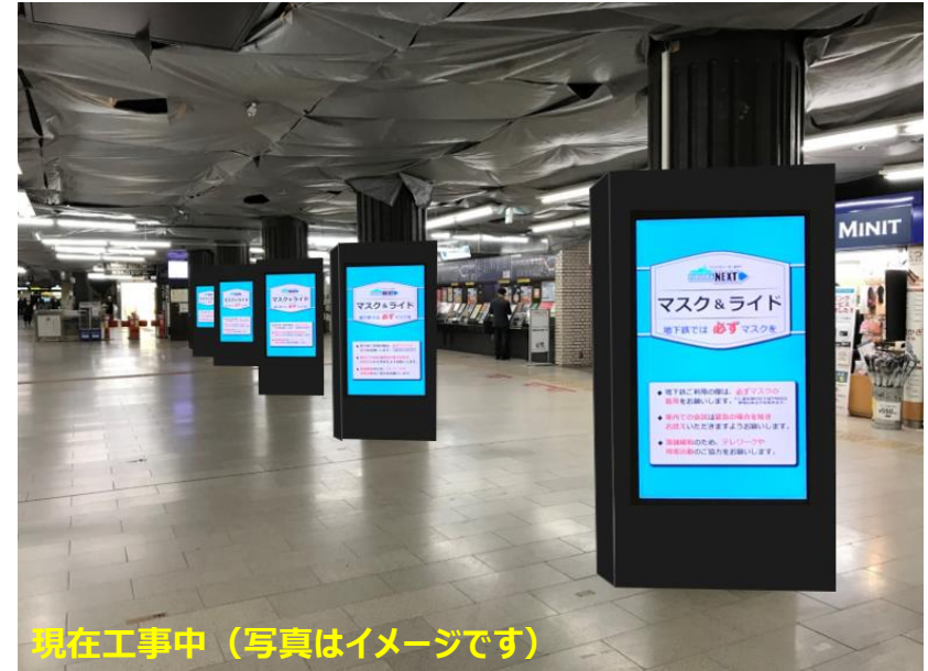
(新設) 東側コンコース 65インチモニター10面
